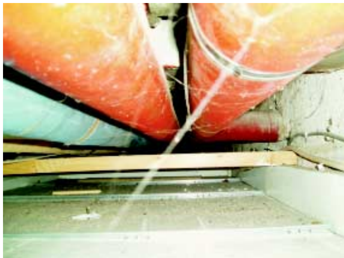
Nyinredd lägenhet - ventil slutar i undertak.
